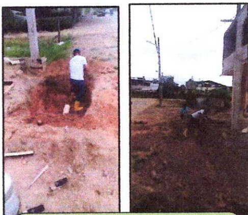
AMPLIACIÓN DE RED SECUNDARIA Y TERCIARIA EN SECTOR SARA CAVERO, CALLE 1º DE ENERO Y VÍA A LOS CEIBOS; Y CONSTRUCCIÓN DE CAJA DOMICILIARIA
